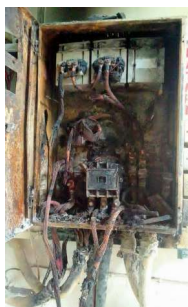
Wasserkraftwerk: Folgen des Kurzschlusses
